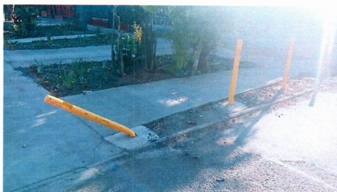
Deterioro de segregador en Molinare con Ciudad Real
