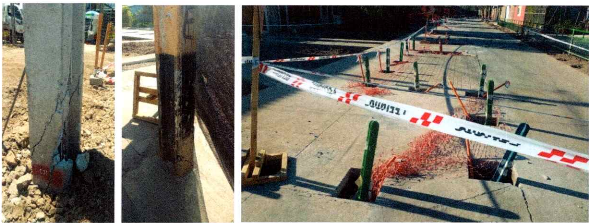
Postaciones con grietas
