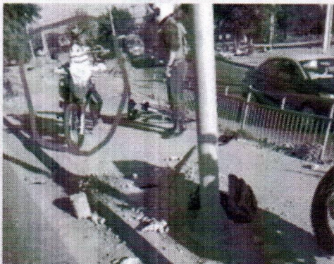
Daños y robo de cableado. Sector Caletera Vespucio Norte - Calle G.
