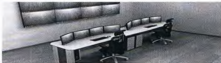
Sala de monitoreo, apta para 8 operarios.
