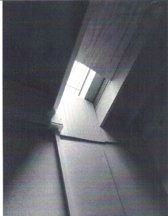
Lucarna en dormitorio N°2, no se encuentra en ubicación señalada en el permiso de edificación P.E. 18/2020, si bien son modificaciones acogida a ART. 5.2.8 de la OGUC. No cumplen con una eficiente ventilación.
