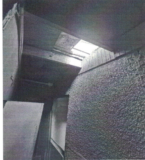
Lucarna en dormitorio N°1, no se encuentra en ubicación señalada en el P.E. 18/2020, si bien son modificaciones acogida a ART. 5.2.8 de la OGUC. No cumplen con una eficiente ventilación.
