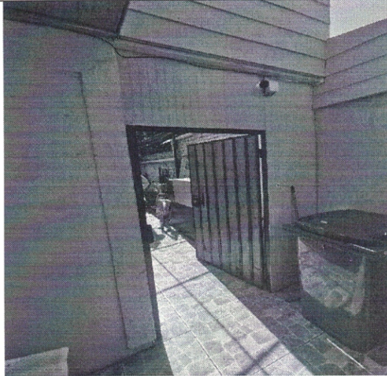
Entrada a Casa-Habitacional, Puerta presenta apertura a lado contrario
