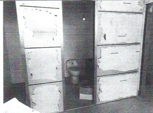
Baño 1, Sin terminaciones de vanitorio e instalaciones eléctrica sin terminar
