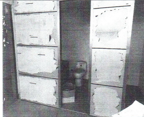
Baño 2, Sin terminaciones de vanitorio e instalaciones eléctrica sin terminar
