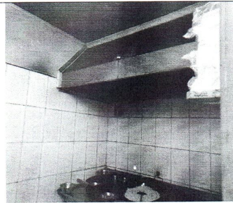
Campana de cocina
