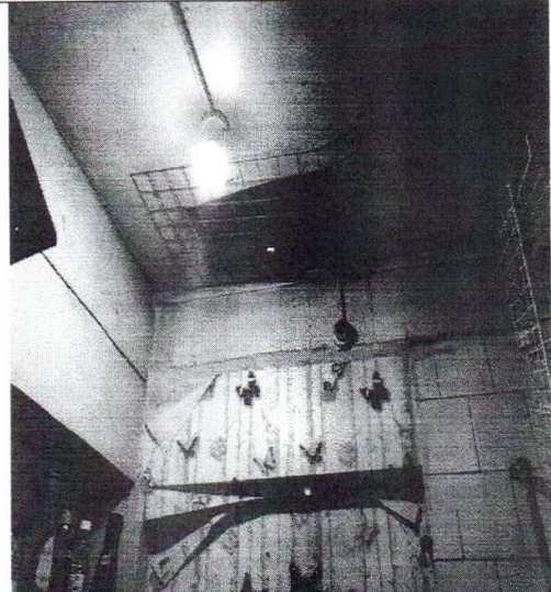
Extractor de Aire de Baño N°1 Sin Funcionar
